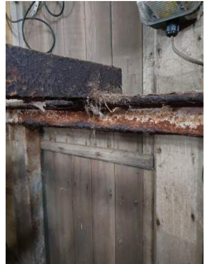
b) Bell frame corrosion
